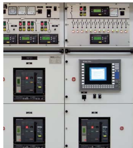
NAVI MILITARI Man Machine Interface Gestione controllo Generatori Fincantieri Fregate classe "HORIZON"
