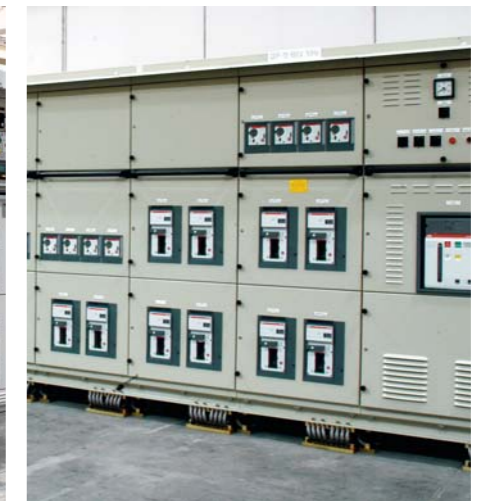
Quadro Distribuzione Principale 660V-4000A-74kA Fincantieri Portaerei "Conte di Cavour"
