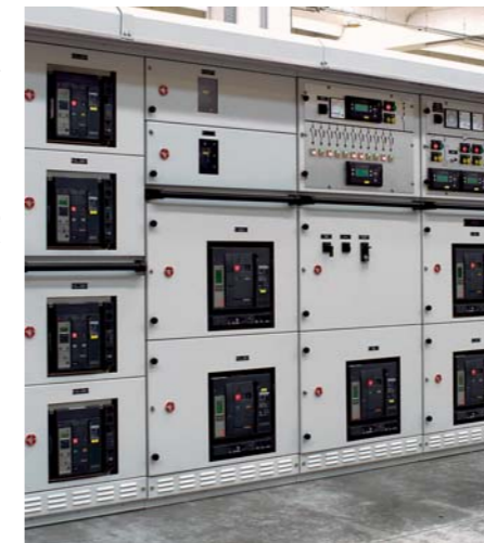
Main Switchboard 440V-5780A-75KA Fincantieri (progetto Italo-Francese) Fregate Classe "HORIZON"
